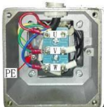
Подключение проводов э/двигателя
